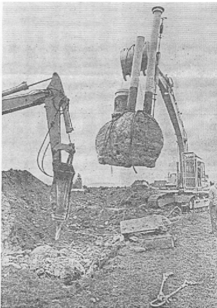
Der Stahlmast der Hochleistungssirene wurde mitsamt den Tanks für Kompressoranlage und Druckluftvorrat demontiert. Foto: Ruppert
